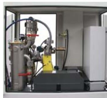
Impianto elettrico montato in cabina
