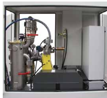
Stationäre E-Anlage in Schutzgehäuse
